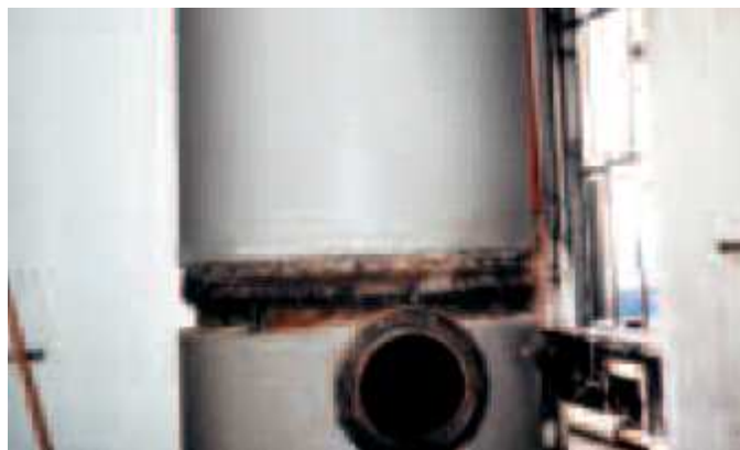
Matériaux contenant de l'amiante pour l'isolation des chaudières
