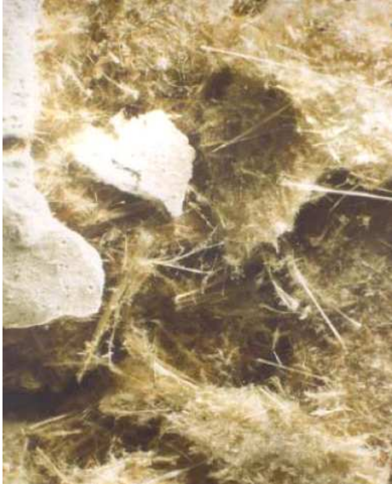
Flocage composé de laine minérale et d'amiante
