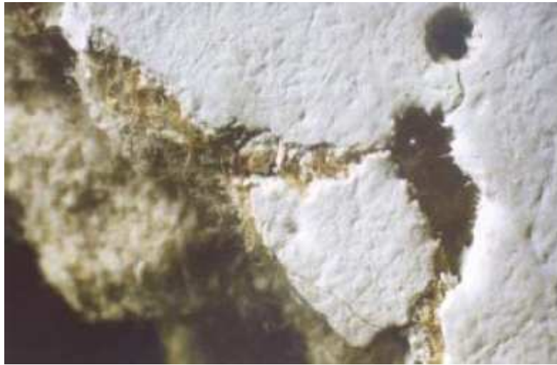
Plaque de faux plafond composé de laine minérale et d'amiante
