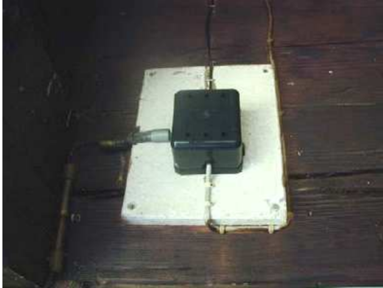
Carton d'amiante derrière un boîtier téléphonique
