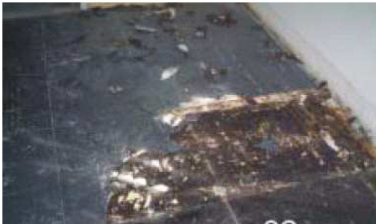
Dalletes d'amiante lors d'un assainissement
