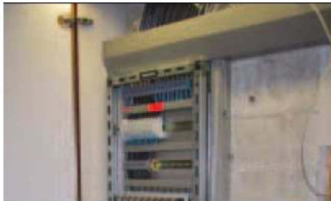
Panneaux légers contenant de l'amiante servant de revêtement de protection incendie
