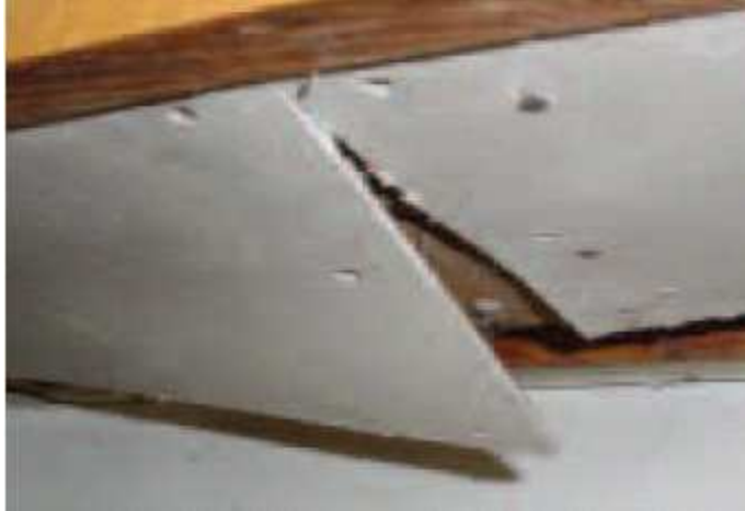
Panneau léger contenant de l'amiante
