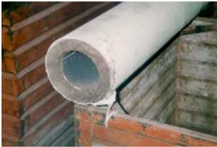
Calorifugeage contenant de l'amiante
