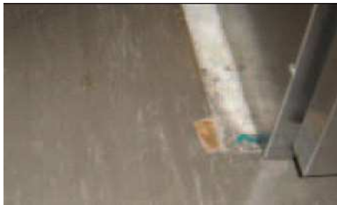
Revêtement de sol contenant de l'amiante
