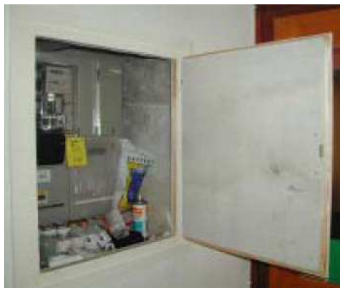
Caisse de sécurité avec plaque de protection antifeu contenant de l'amiante à l'intérieur de la porte
