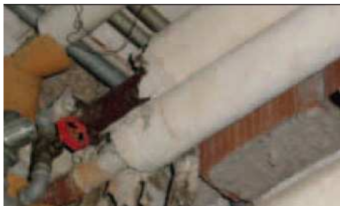
Mortier contenant de l'amiante pour isolation de conduite
