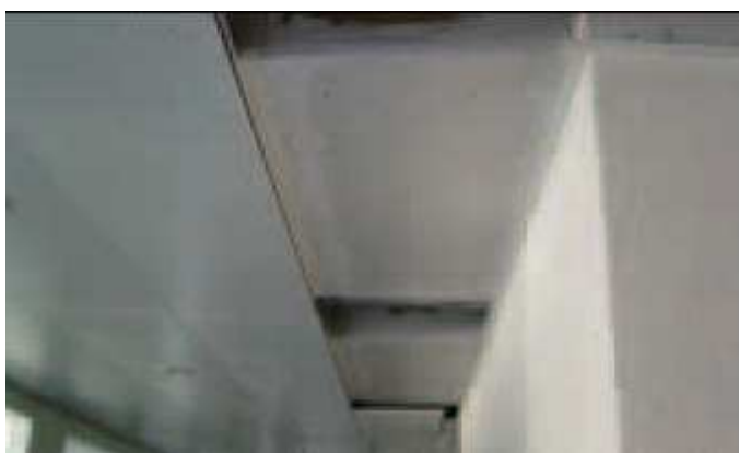
Panneaux agglomérés contenant de l'amiante
