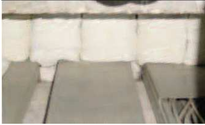
Coussins contenant de l'amiante destiné à circonscrire les incendies
