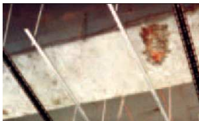
Revêtement à base d'amiante floqué
