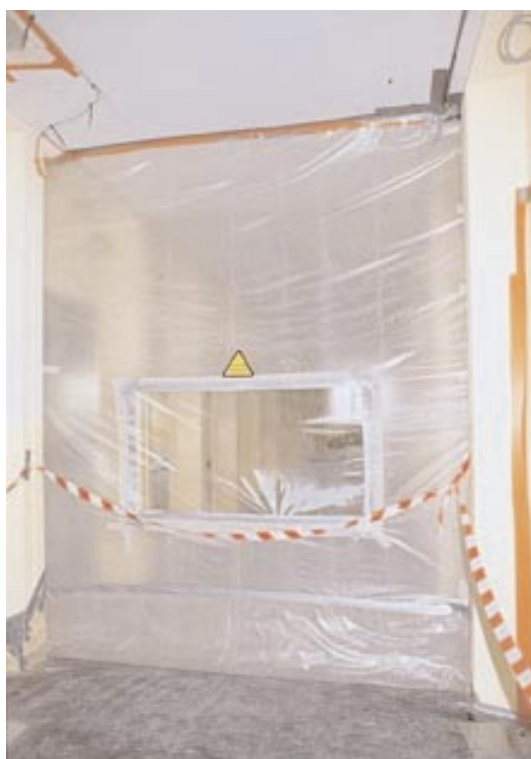
Fenêtre d'observation dans un confinement.
