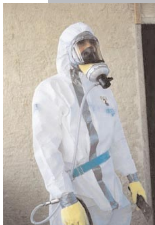
Le système d'adduction d'air comprimé peut être doté d'un filtre P3 monté en série, permettant des débranchements éventuels de courte durée en zone (photo AFPA).
