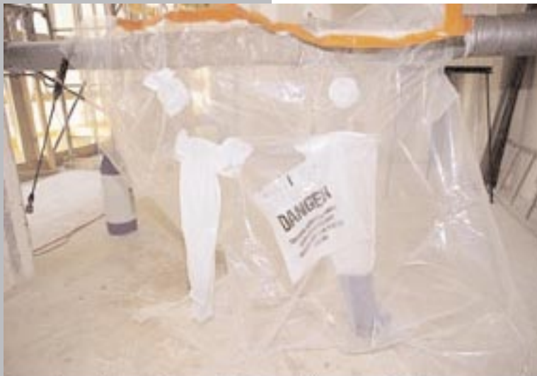
Sac à gants pour le confinement d'une portion de canalisation horizontale.
