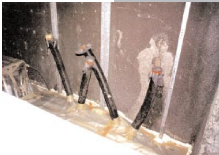
Installation électrique mise hors-service et gaine de passage obstruée.
