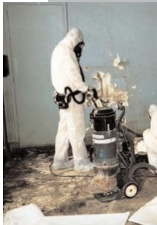
Décollement des dalles sous aspiration (photo CRAM Nancy).
