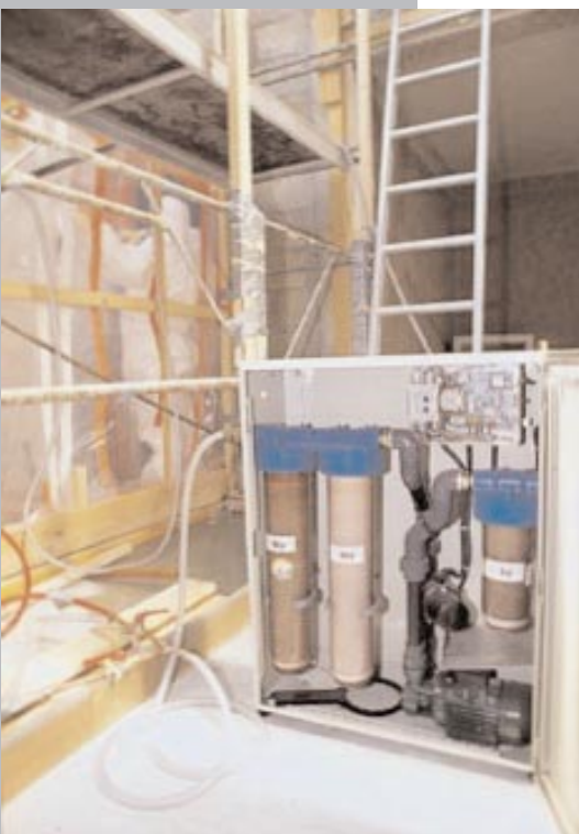
Ensemble de filtration d'eau.
